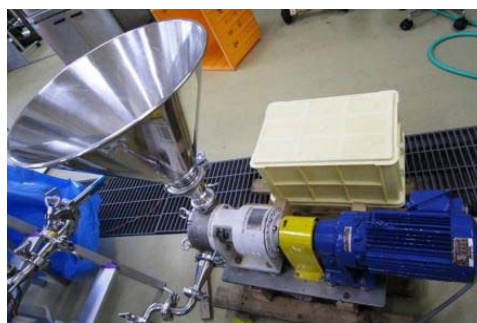
写真4 ロックヒルポンプ
