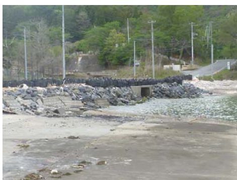
被災した岸壁（土嚢による応急措置）
