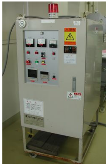
図1 通電加熱電源装置
