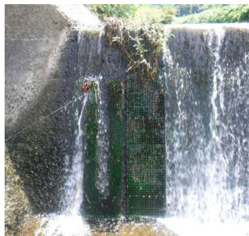
図6 一部破損した芝マット魚道
