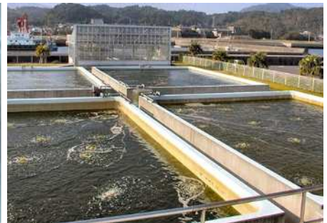
ナンノクロロプシス培養水槽 (140トン水槽)
